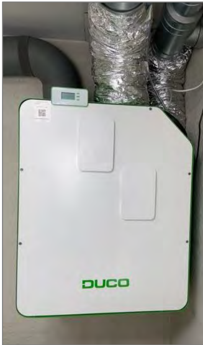
Centrale balansventilatie-box in trappenhuis
