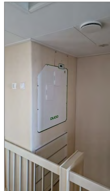
Centrale balansventilatie box en leidingen, door bewoner weggewerkt in kast en verlaagd plafond
